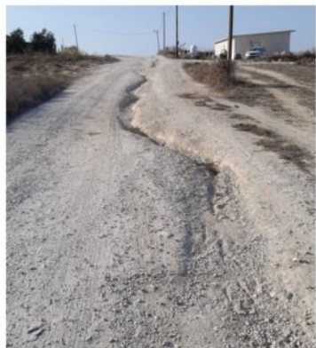
Veien inn til Havat Gilad trenger utbedring
